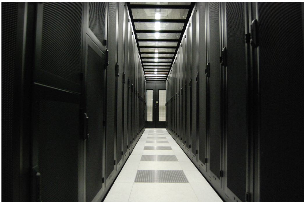
Cold corridor opbouw bij Nedzone
