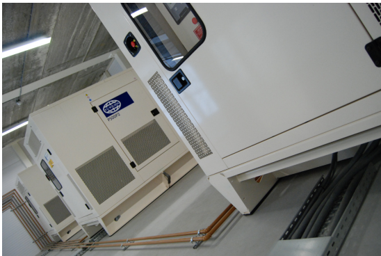
Onze noodstroom generatoren
